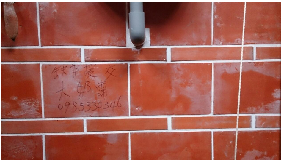
圖二十四 文武廟廁所遭破壞照片
